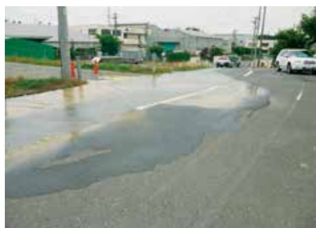
漏水が多発している中支線水路
