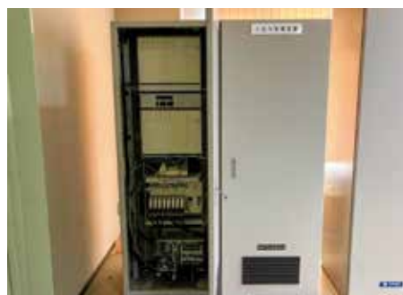
既設県営水管理システム（平成6年度から運用）
