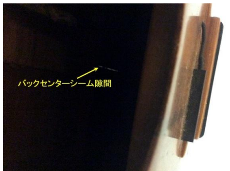
バックセンターシーム隙間
