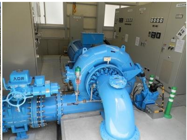
水力発電施設
