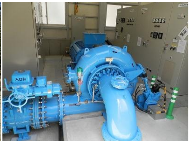
水力発電施設
